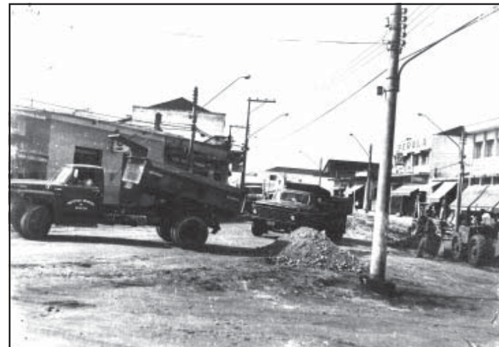
Desbravando e construindo Registro, antiga Av. Dr. Fernando Costa, hoje pref. Jonas Banks Leite no centro da cidade, bifurcação onde se encontra a Praça Joia. Sendo o primeiro calçamento que a região conheceu, antes do asfalto, também, obra do ex-prefeito José de Carvalho.
